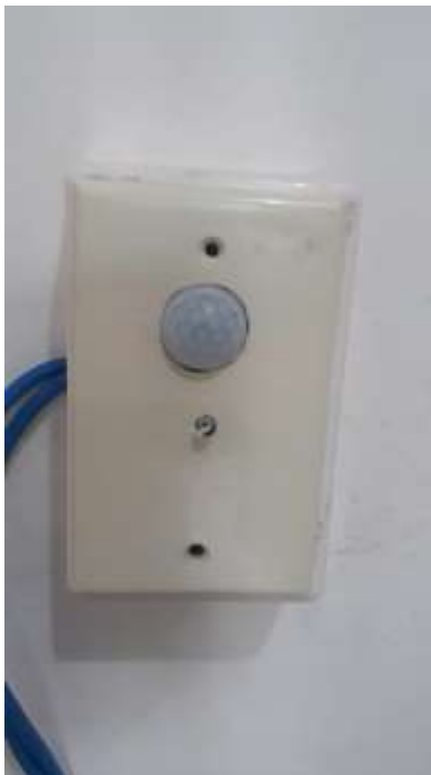
Figura 11: Sensor PIR Instalado. Fuente: Autores, 2019.
